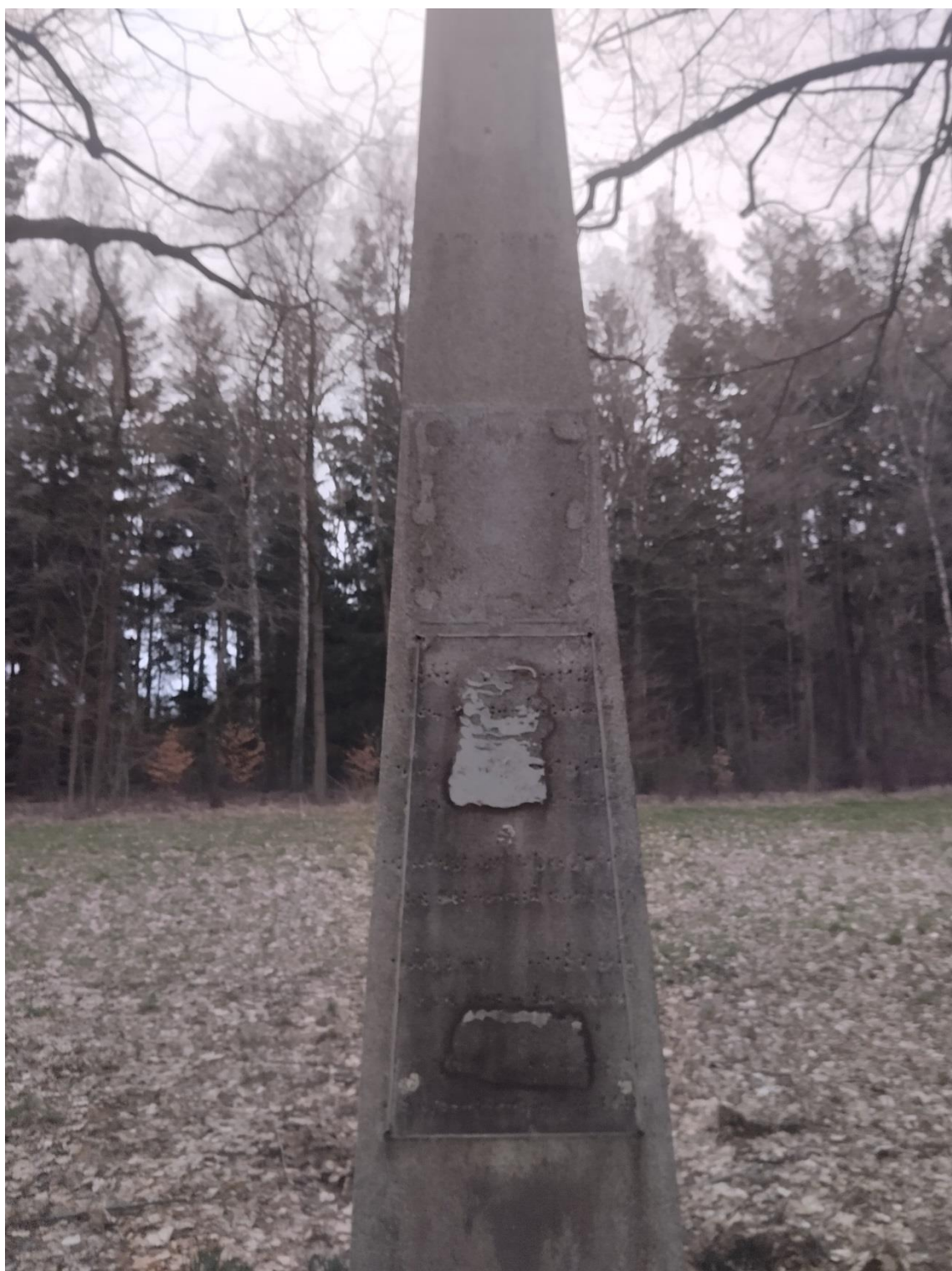
Obrázek 6: Detail přední strany pylonu, stav po odstranění plastového státního znaku a mosazné nápisové desky.
