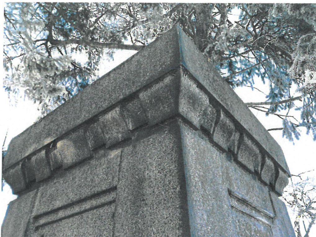
Foto č. 9 – Stav před restaurováním - římsa se zubořezem je silně znečištěna biologickým znečištěním a černými krustami – pravá a přední strana
