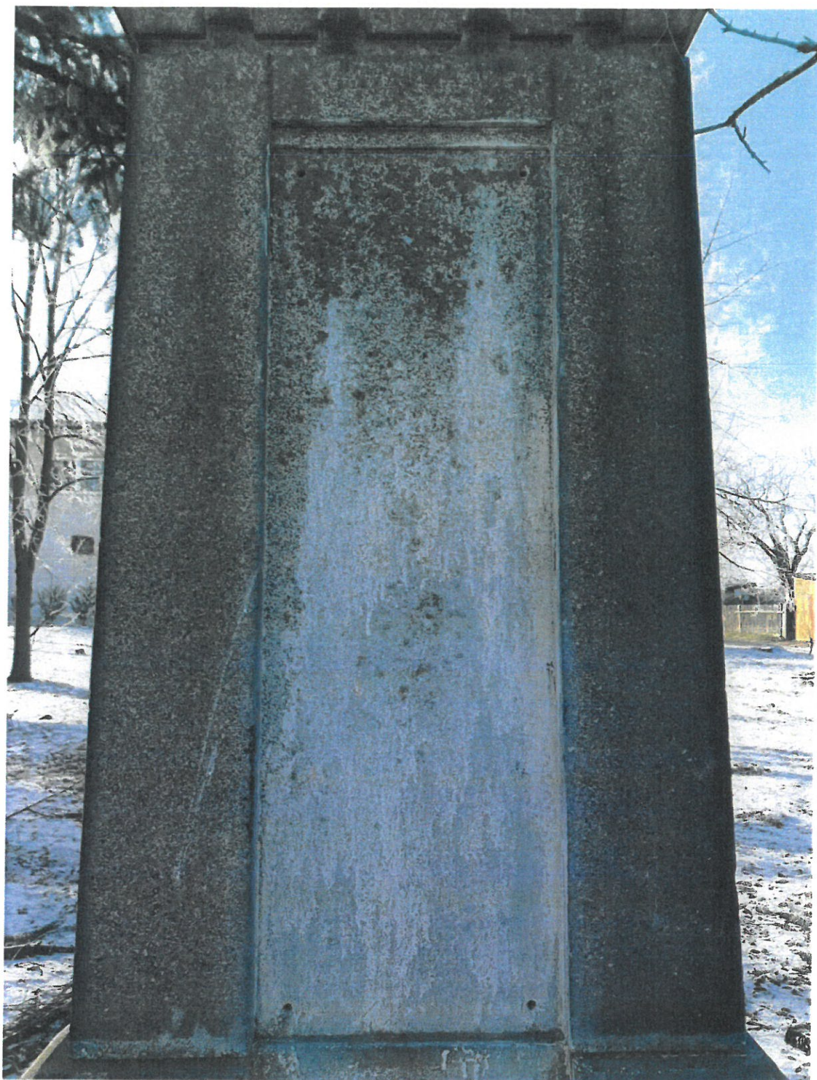
Foto č. 5 – Stav před restaurováním - zrcadlo druhotně natřené bílou barvou, viditelné biologické napadení zejména ve vrchní části – pravá strana
