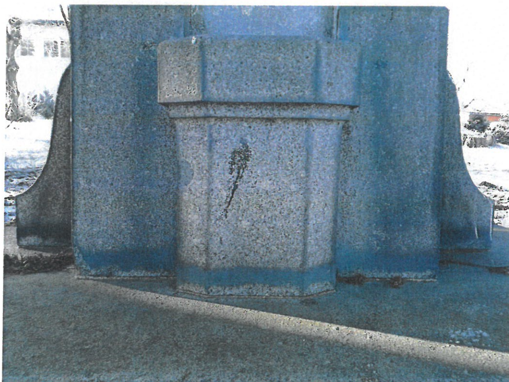
Foto č. 10 – Stav před restaurováním - silné černé krusty na styku podnože a vrchního schodišťového stupně – přední strana
